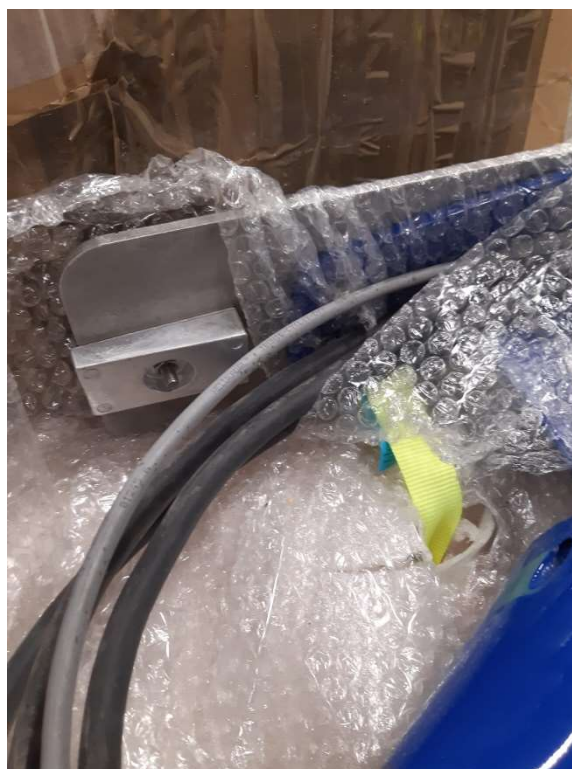
Kabels tussen POD en Controller
